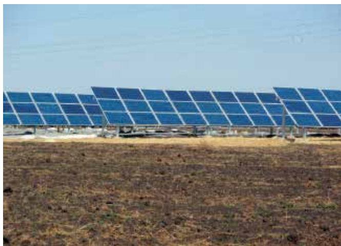
Рис. 1. Солнечные электростанции (СЭС), использующие фотобатареи (ОАО «Сахаэнерго», Якутия) [12]
